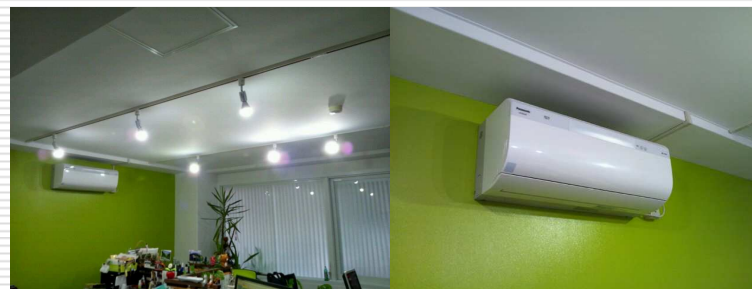
本社オフィスは最新エアコンとLED照明
