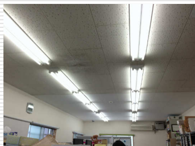
東陽センターのオフィス等はHf式蛍光灯使用
