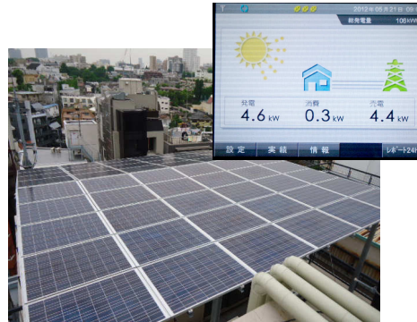
本社 ソーラー設備 9.8kw
