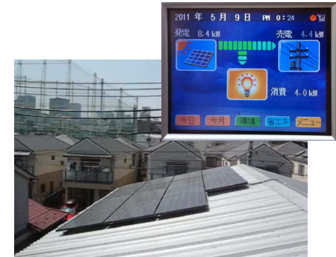
東陽センター ソーラー設備 10kw
