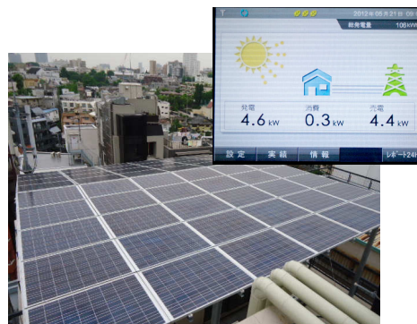
本社 ソーラー設備 9.8kw
