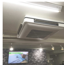
2016/6換装 小売事業部エアコン
