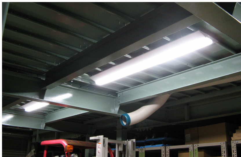
2018/5導入 新型LED照明(全9台)
