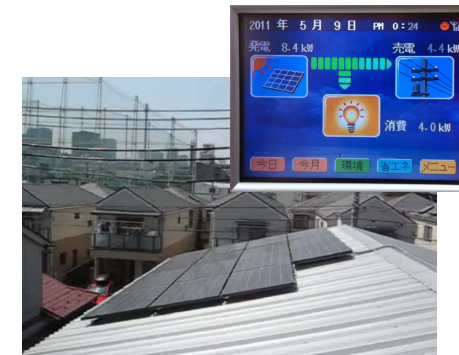
東陽センター ソーラー設備 10kw
