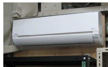
2018/5導入 新作業室用エアコン
