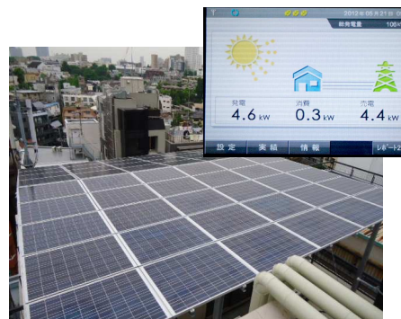
本社 ソーラー設備 9.8kw
