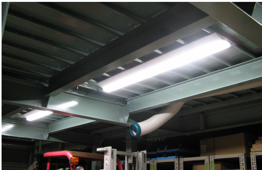
2018/5導入 新型LED照明(全9台)
