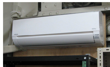
2018/5導入 新作業室用エアコン
