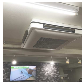
2016/6換装 小売事業部エアコン
