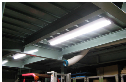
2018/5導入 新型LED照明(全9台)
