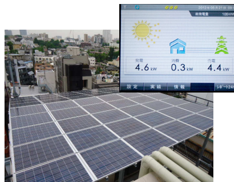
本社 ソーラー設備 9.8kw
