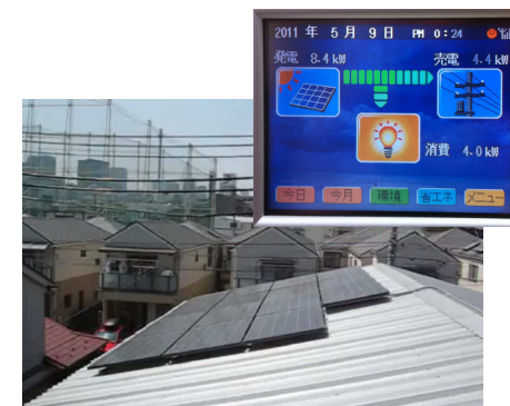
東陽センター ソーラー設備 10kw
