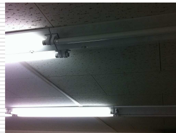
蛍光灯を抜いて間引き点灯
