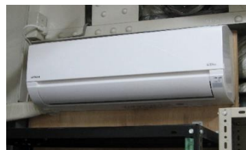
2018/5導入 新作業室用エアコン
