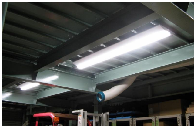
2018/5導入 新型LED照明(全9台)
