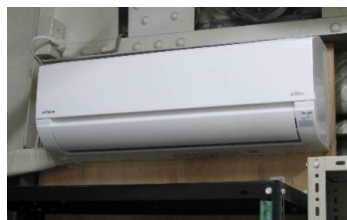
2018/5導入 新作業室用エアコン
