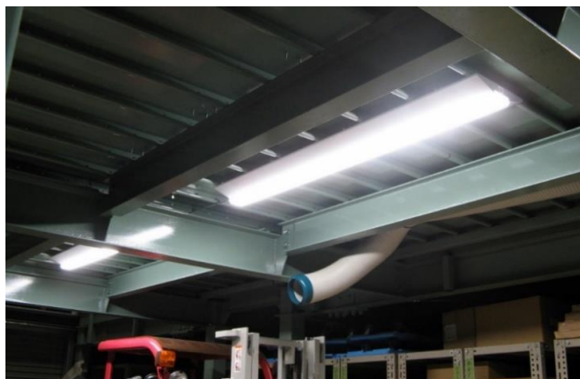
2018/5導入 新型LED照明(全9台)
