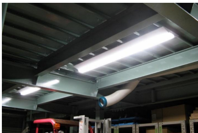
2018/5導入 新型LED照明(全9台)
