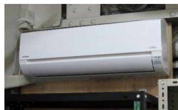
2018/5導入 新作業室用エアコン
